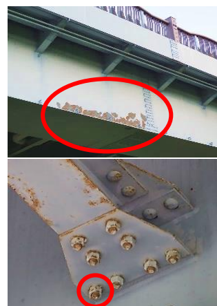
旭川市の橋の腐食 腐食
